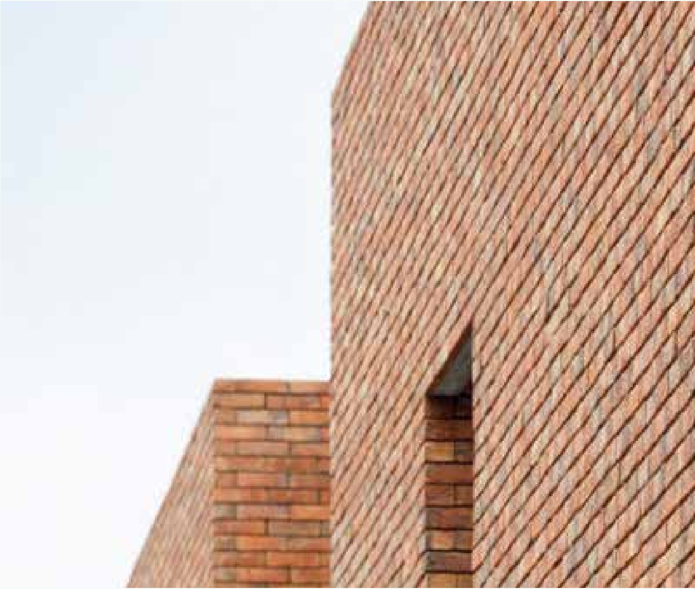
Herkenbaar: bijvoorbeeld baksteen
